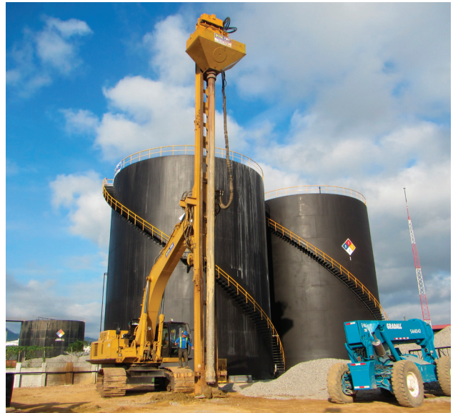
Tanques de Almacenamiento de Aceite - Fase II, Puerto Barrios, Guatemala
